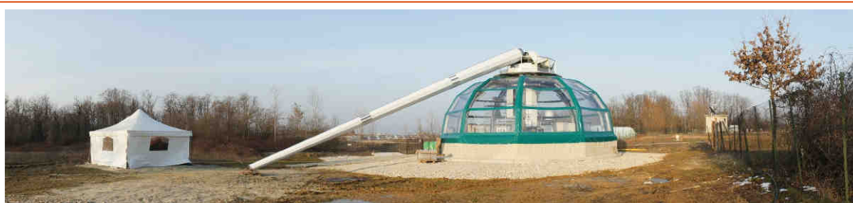
Foto #3: Generatore KiteGen® Stem On-shore da 3 MW, in costruzione a Sommariva Perno (ITA – Dic 2010)
